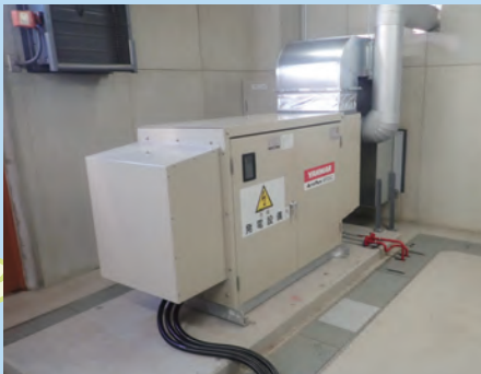
■ 令和元年度施工 斜里防災ステーション発電機
