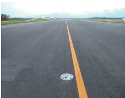
■ 平成29年度施工 女満別空港誘導灯
