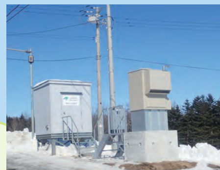
■ 令和元年度施工 湧別光中継局舎発電機
